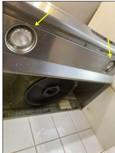
Vent fan light is inoperable.
