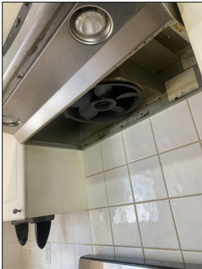
Exhaust fan missing the fan covers.
